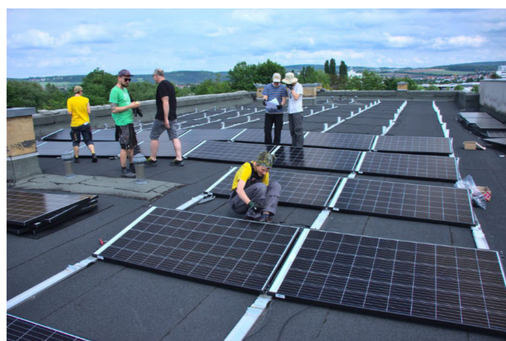
Solaranlage der Selbstbaugemeinschaft SoLocal Energy e.V. Beispielgrafik ohne denkmalfachliche Beurteilung Quelle: https://www.solocal-energy.de/wp-content/uploads/2022/07/IMG_0009-1024x682.jpg
